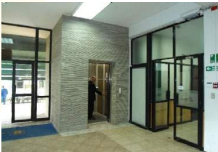
Ascensores: Edificio Facultad Cs. Sociales
